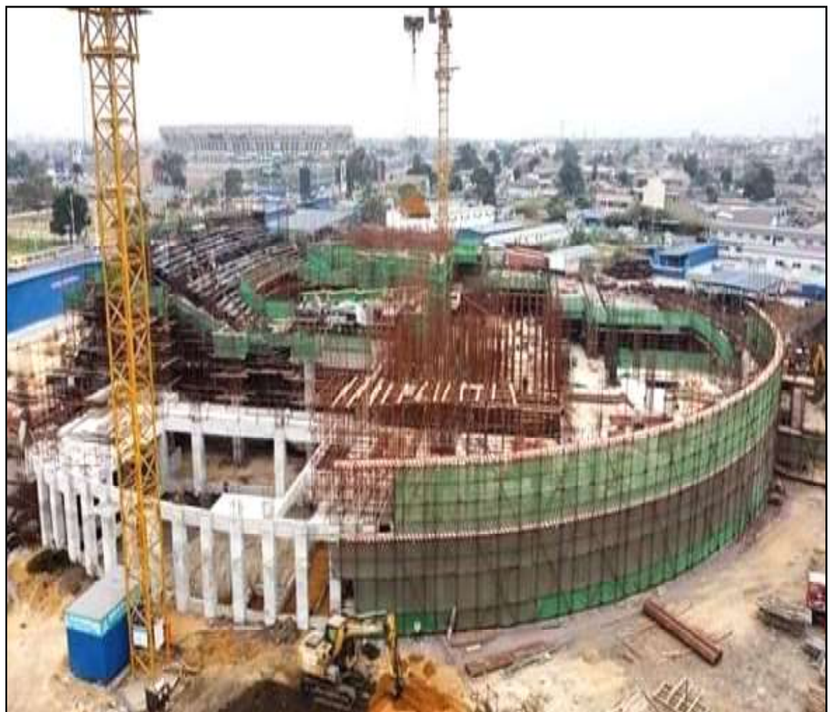
Evolution à grande vitesse du chantier du Centre culturel et artistique de Kinshasa
