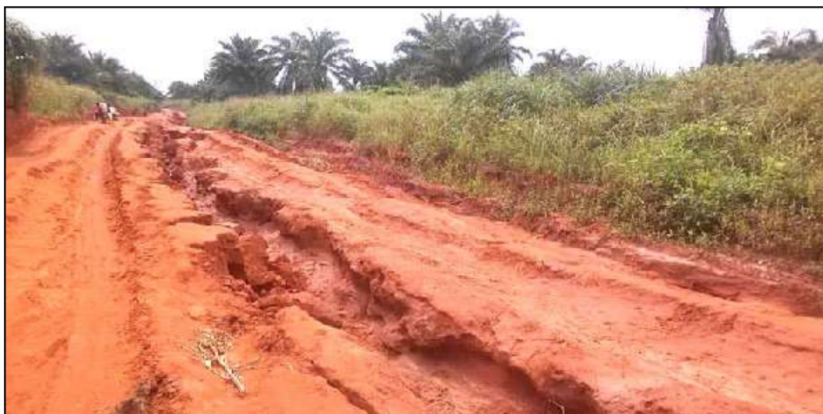
La route Mbuji-Mayi-Kabeya Kamuanga n'existe plus que de nom
