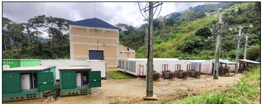
Des containers bien rangés pour le minage de Bitcoin
