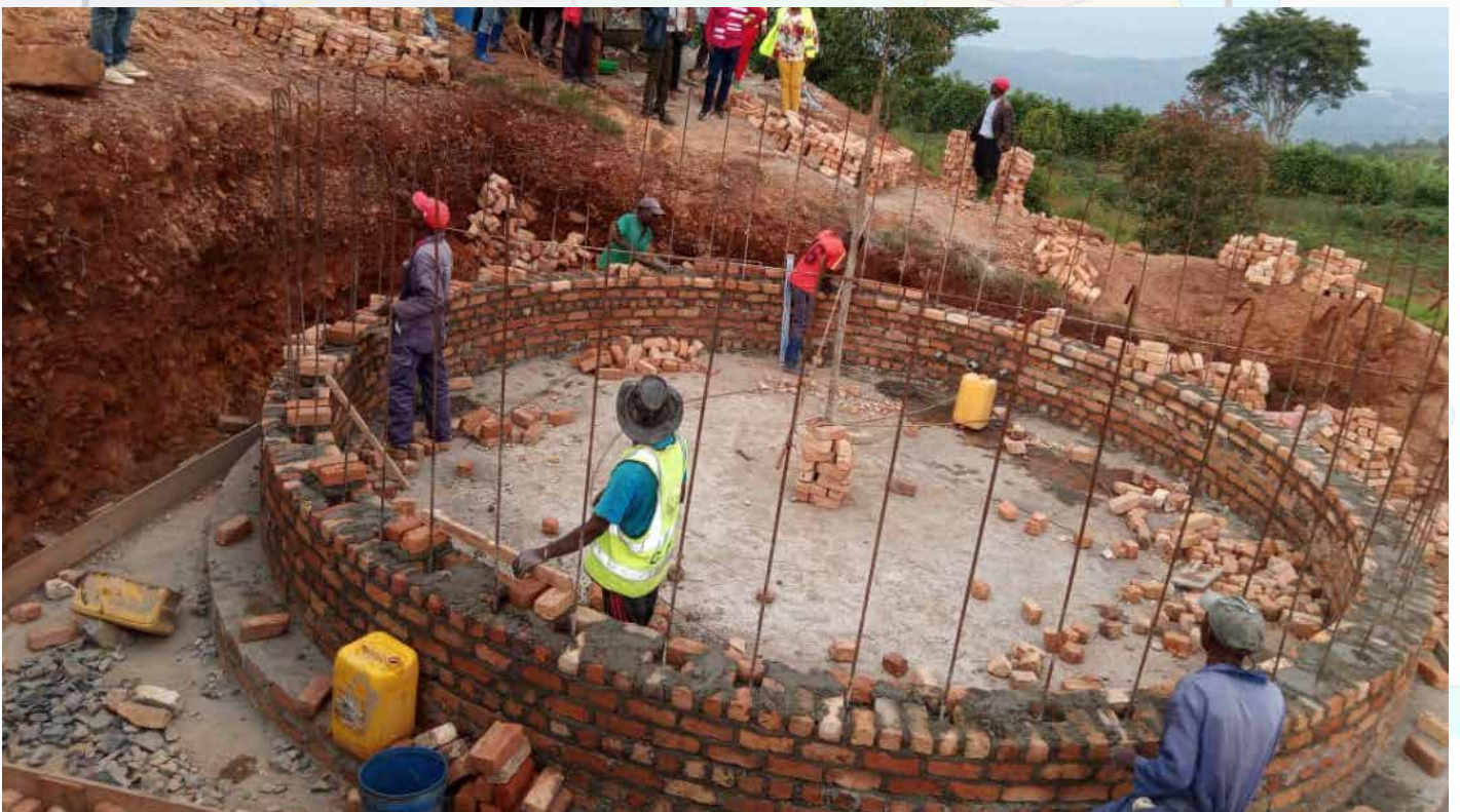
Construction d'une borne fontaine dans le territoire de Walungu. (Photo Droits Tiers).
